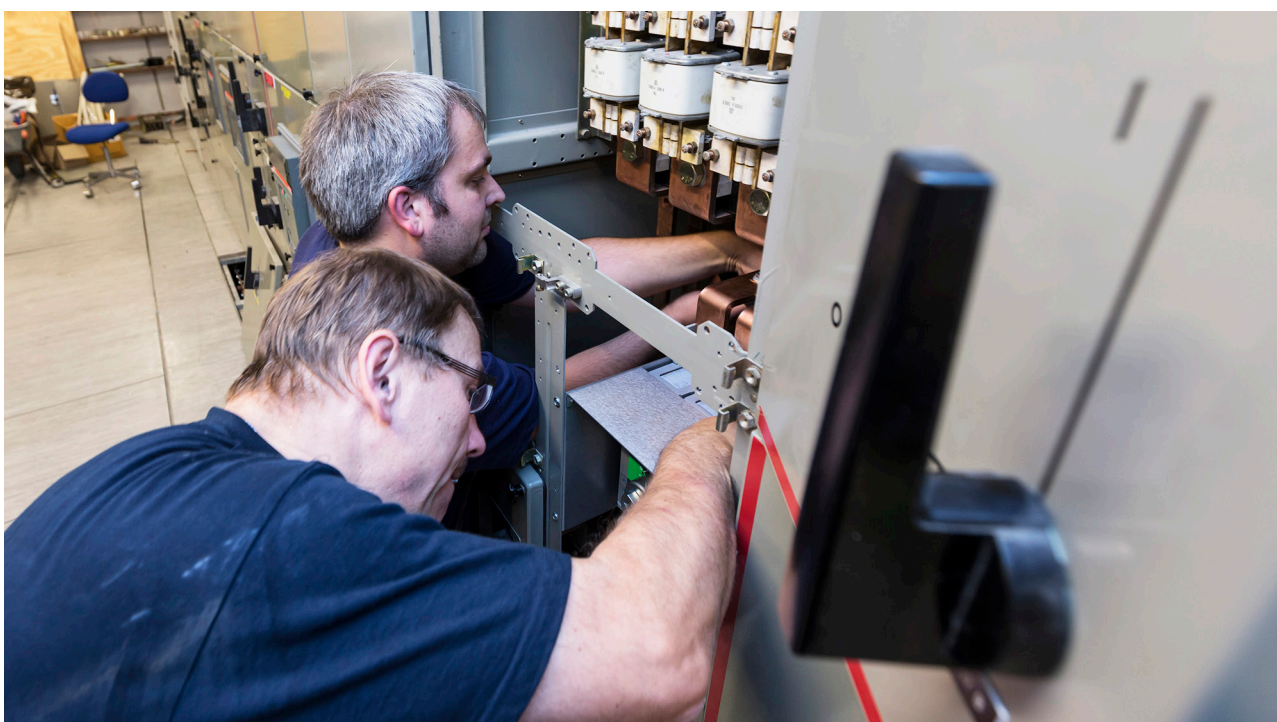
Service på spændingsløs tavle.
