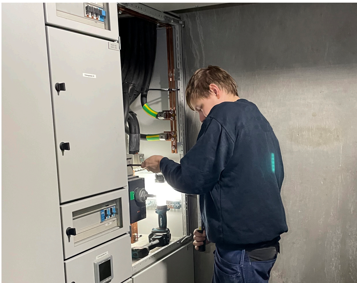
Service på spændingsløs tavle.
